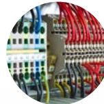
Schaltanlagen für Elektronik Switch gears
