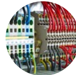
Schaltanlagen für Elektronik Switch gears
