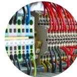
Schaltanlagen für Elektronik Switch gears
